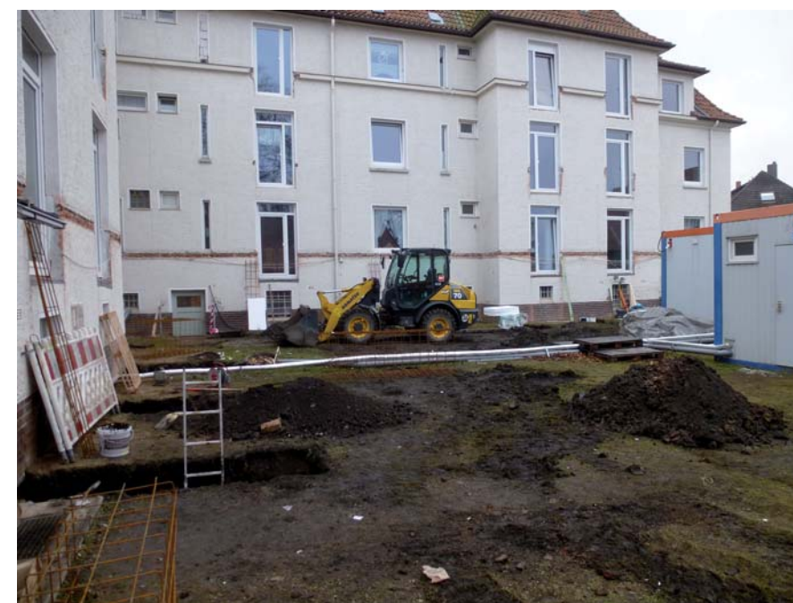
Hofbereich der Wohnanlage Friedrich-Ludwig-Jahn-Str. 13-13b mit Sanitärcontainer
