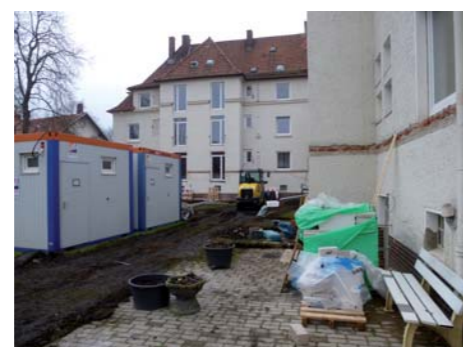
Sanitärcontainer zu Mieterversorgung
