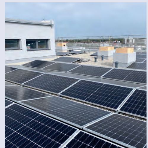
Photovoltaikanlage auf dem neuen Dach
